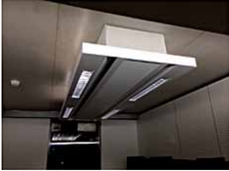
Şekil 2: Chilled Beam Ünitesi İç mekan Görünümü
