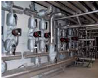
Tamamı frekans kontrollü ısıtma zon pompaları.
