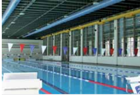
Kapalı yarı-olimpik havuz.%100 taze havalı, ısı geri kazanımlı klima santralinin şartlandırdığı havayı mekana taşıyan dairesel kanallar.
