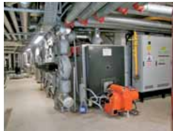
Isıtma Kazanları ve ana pompaları.
